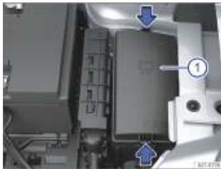
Fig. 154 En el vano delantero: caja de fusibles.
